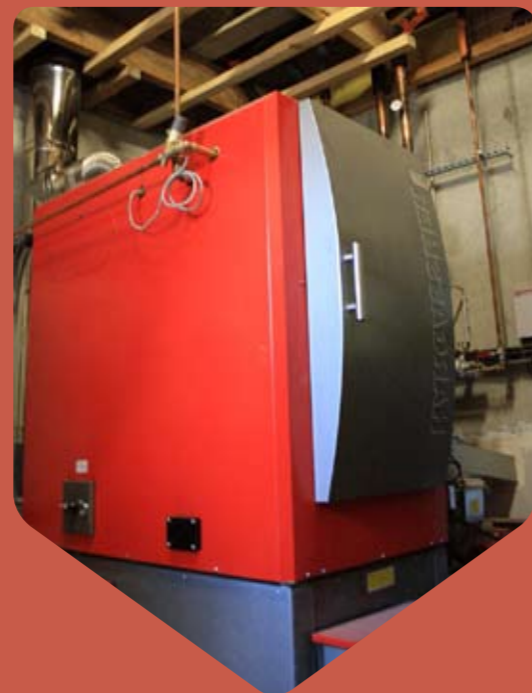
Chaudière à bois déchiqueté
