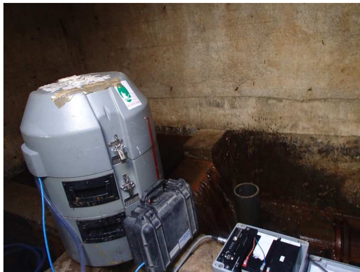
Photo 3 -Préleveur automatique et fluorimètre placés dans le captage
