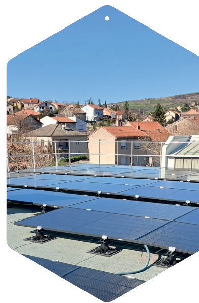
Installation photovoltaïque maison de santé Aguessac
