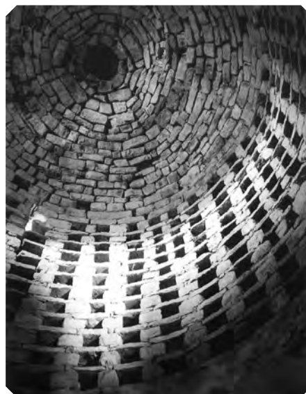
Intérieur du pigeonnier de Comprégnac (extrait de l'ouvrage des Adralhans « Colombiers - Pigeonniers »)
